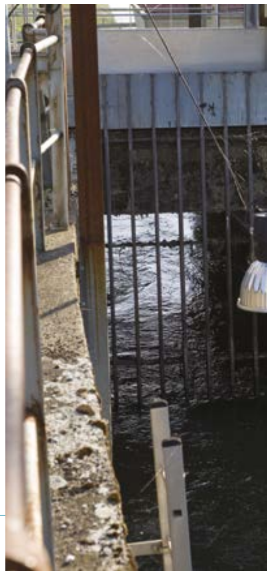
Système de piège des smolts en dévalaison centrale de Camon (31) © SMEAG
